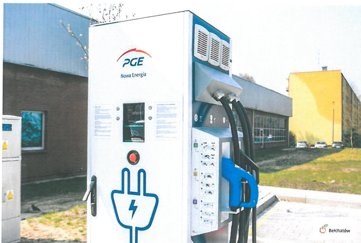
Rysunek 13. Stacja ładowania samochodów elektrycznych w Bełchatowie
